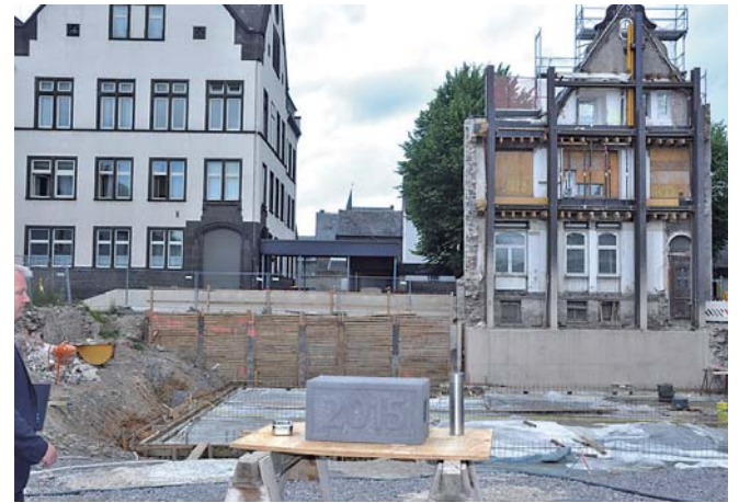
Die Arbeiten an der Baustelle gehen gut voran. Die historische Giebelwand wird in den Neu- und Erweiterungsbau des Verwaltungssitzes der Volksbank RheinAhrEifel integriert.
